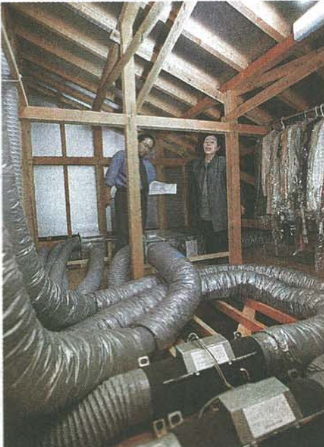
屋根裏部屋にある配管。季節によって空気の流れの向きを変える—千葉県茂原市で
